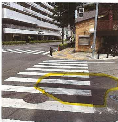
▲谷戸町の空洞発生箇所(黄色の囲み)
